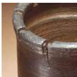
FISSURES DANS LES SEGMENTS
